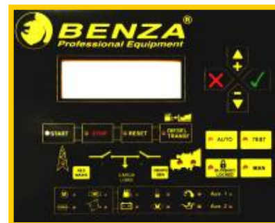
Fig.2 Controlerul digital al panoului de transfer sarcina
